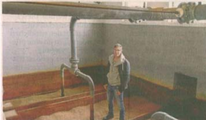
Normalerweise reinigt der Sandfilter das Wasser 24 Stunden am Tag. Freibadleiter Bernd Marschalck präsentierte am Datum der nominellen Saisonöffnung die Anlage im Trockenzustand.
